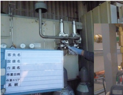
安全弁作動検査
