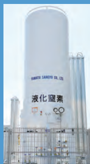
液体窒素 CEタンク 高品質製品検査の 充実のため、窒素 ガスの供給を増強 しました。
